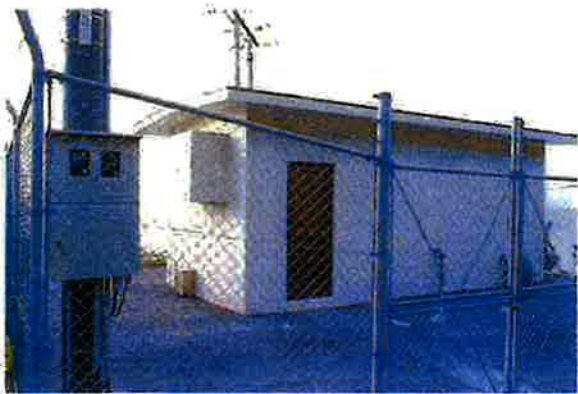
上原増圧ポンプ場
