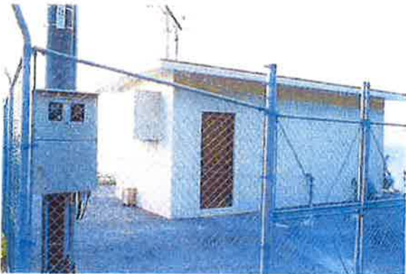
上原増圧ポンプ場
