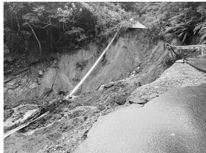
村道饒波石山線崩落現場
